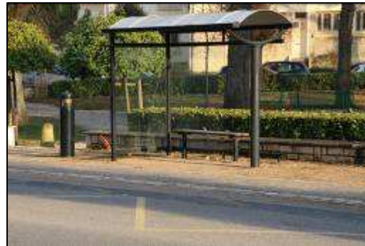
Des arrêts de bus dégradés
